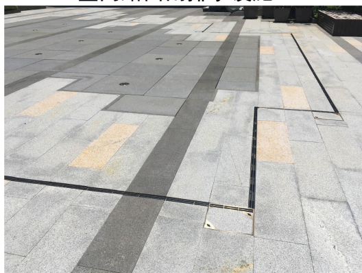
区内路面雨排水设施 8
