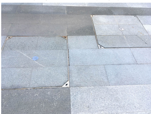
区内路面雨排水设施 2
