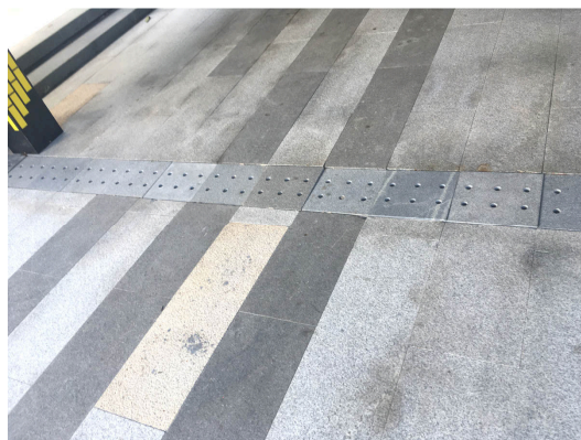
区内路面雨排水设施 7
