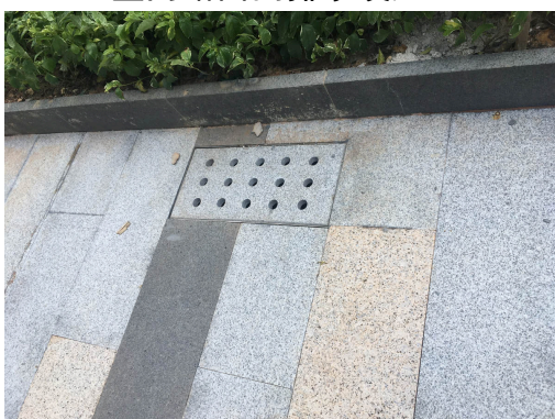
区内路面雨排水设施 4
