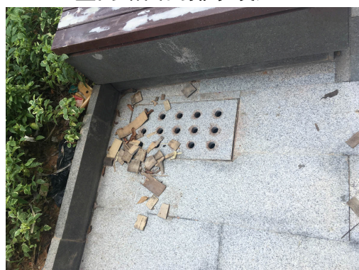
区内路面雨排水设施 5
