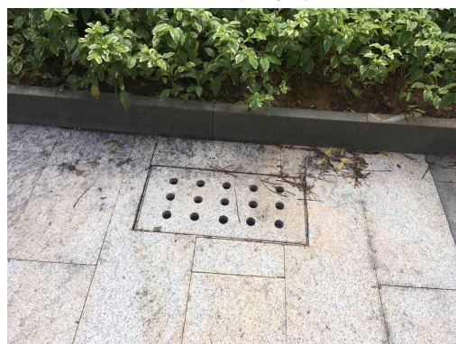
区内路面雨排水设施 3
