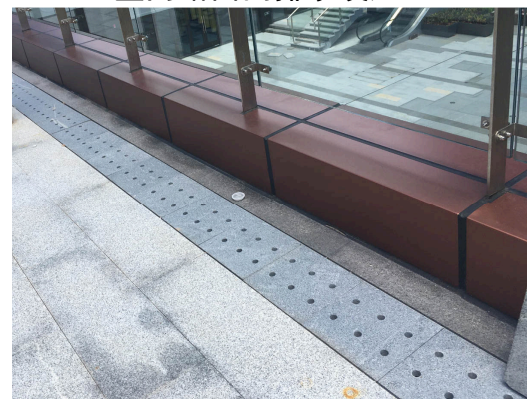
区内路面雨排水设施 11
