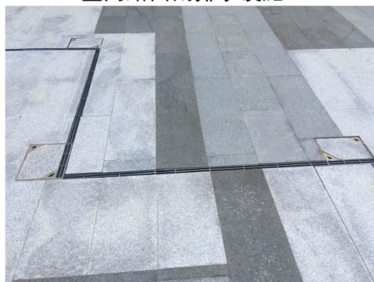
区内路面雨排水设施 9
