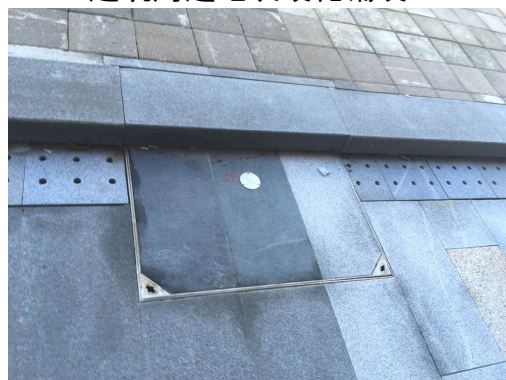
区内路面雨排水设施 1
