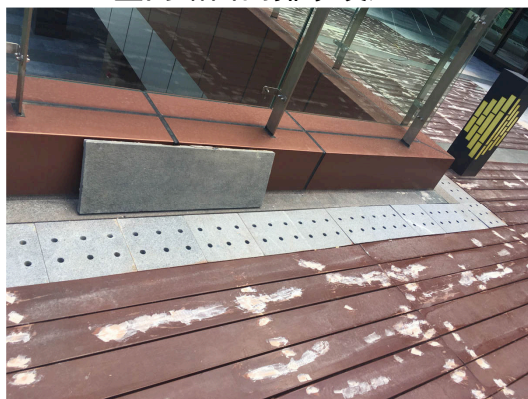
区内路面雨排水设施 10
